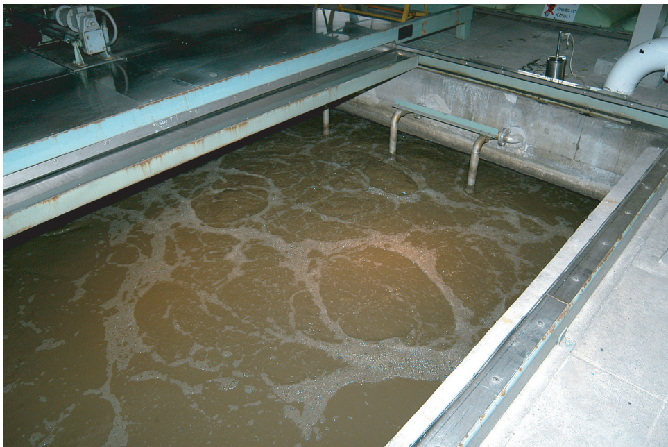
下水処理場のばっ気槽(反応槽) ©H.OOSAKI
